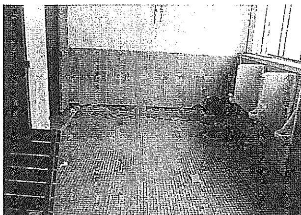
北側便所 床沈下
