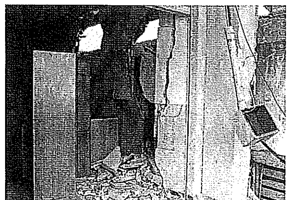
4階階段部分 壁体落下
