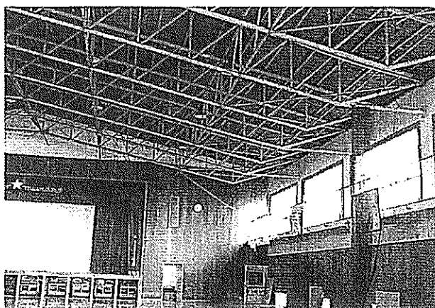
2階 天井トラス張筋落下
