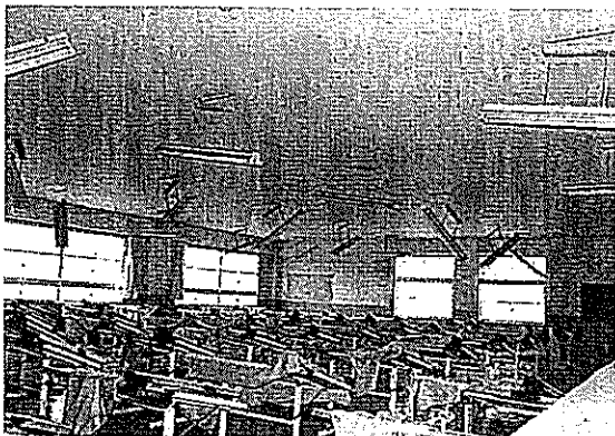
3階製図室 電灯落下
